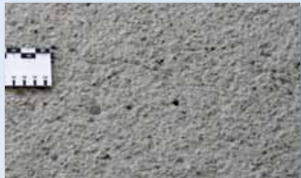
Fräs-/Strahlbild ungeeignet: Reste von Feinmörtel, kein Korngefüge
