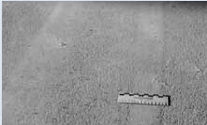
Fräs-/Strahlbild ungeeignet: Reste von Feinmörtel, kein Korngefüge
